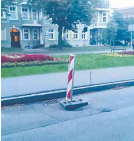
Zapadnięta jezdnia na Jana Pawła II przy studzience kanalizacyjnej.
