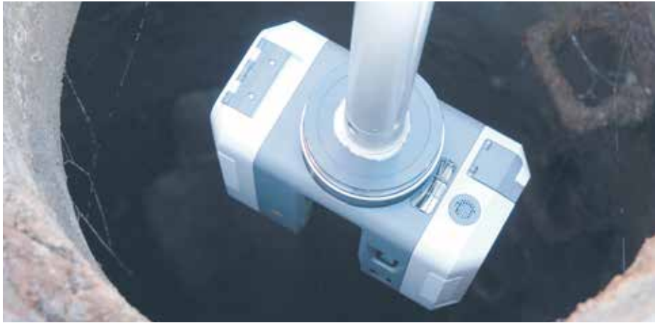
Głowica skanera wprowadzana do wnętrza studni kanalizacyjnej.
