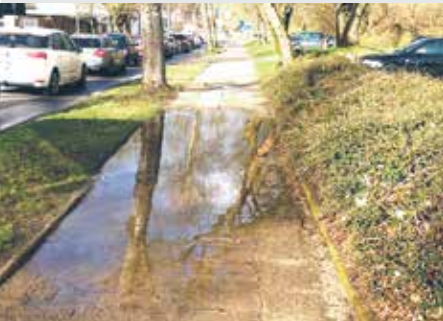
Uszkodzona studzienka oraz za-padnięty chodnik, Papieža Pawła VI – Alert w realizacji
